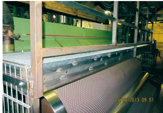
Verkleidungen zum Schutz vor Eingriff nach dem Unfall angebracht
