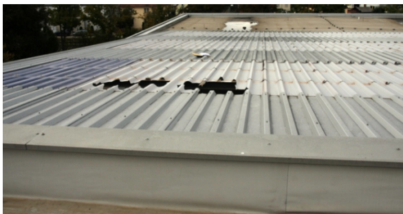
Bild 1: Dachansicht mit Unfallstelle von oben
