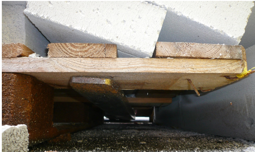
Bild 2: Ein Fuß der unteren Palette fehlte vollständig
