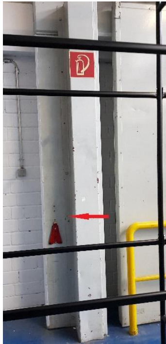
Bild 1: Fehlender Feuerlöscher in der Arbeitsstätte
