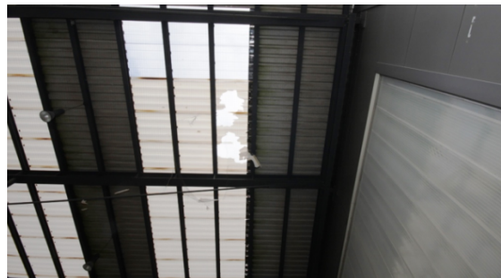
Bild: 2 Dachansicht mit Durchbruchstelle von unten
