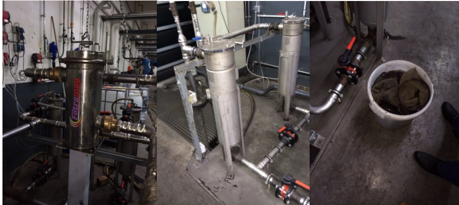
Abbildung 2 Filter für die Aufbereitung des Brauchwassers; links Magnetfilter; Mitte Gehäuse für Sackfilter; rechts Sackfilter bei der Reinigung
