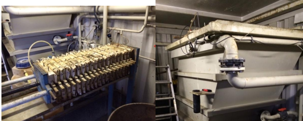
Abbildung 3 Systemelemente; links Kammerfilterpresse; rechts Schrägklärer
